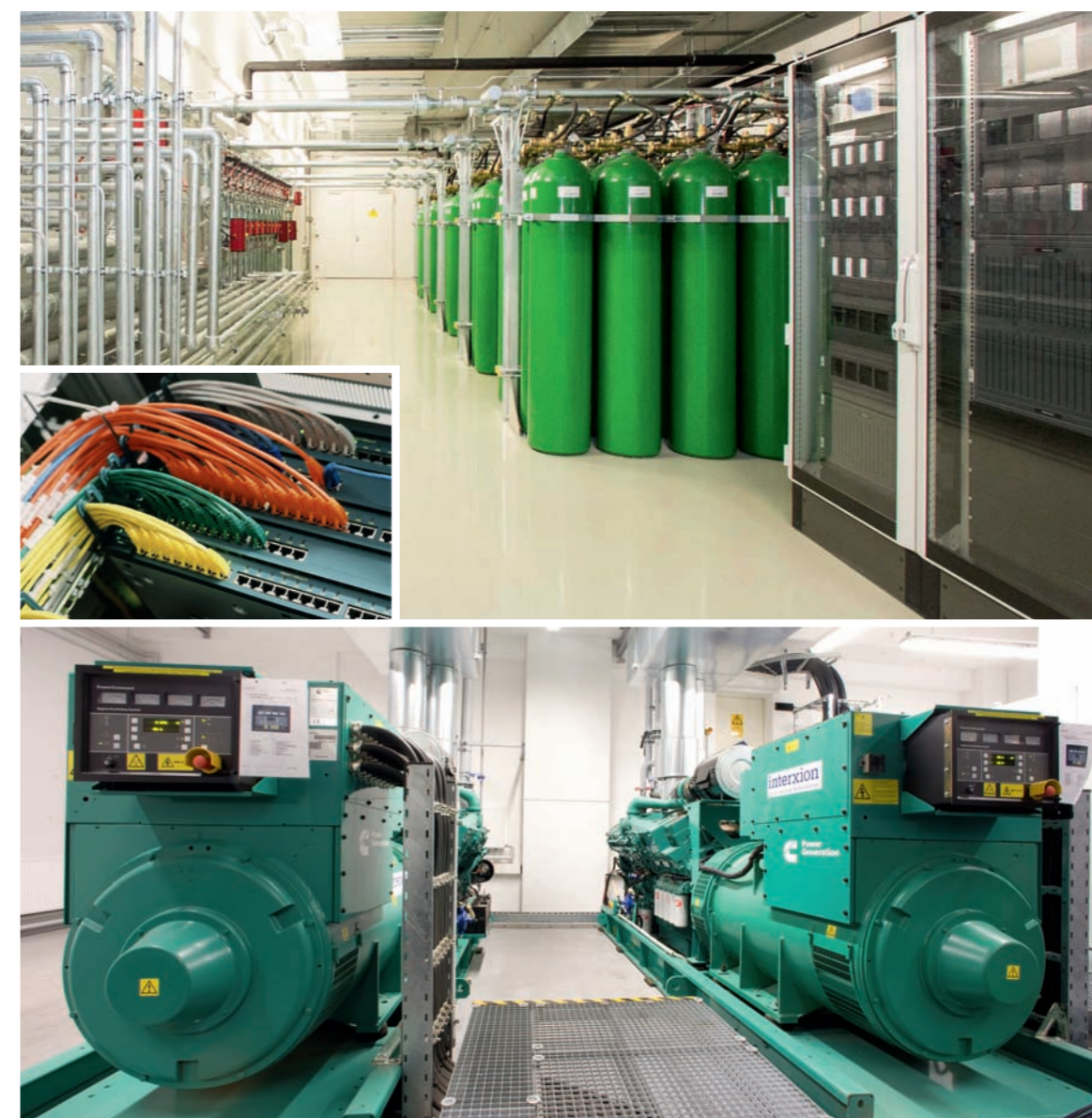
Interxion setzt auf modernste Sicherheitstechnik, z.B. bei Löschgass-Anlagen (oben) und redundanten Notstromsystemen für einen unterbrechungsfreien Dauerbetrieb (unten). Der Campus bietet direkte Verbindungen zu über 450 Carriern und Internet Service Providern (Mitte). Abbildung linke Seite: Der hochmoderne Interxion-Campus in Frankfurt.
