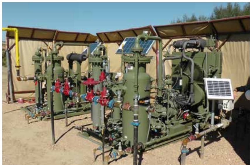
Förderanlagen von Tekton Energy
